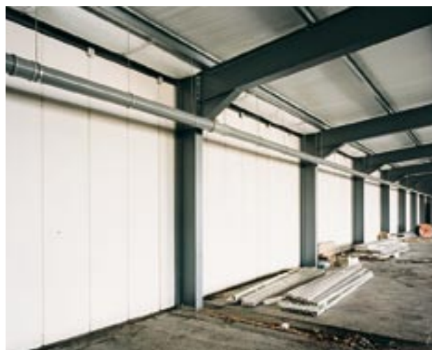
Aan de andere kant van de brandwand zijn de smelttankers intact gebleven: de brandwand heeft zijn functie vervuld.
