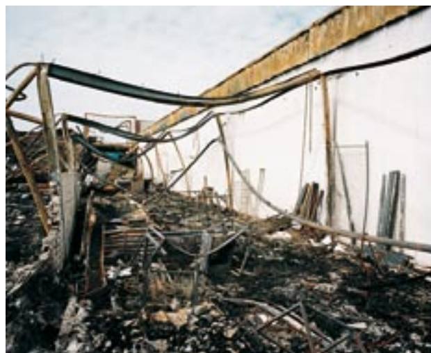
De smelttankers zijn bezweken aan de brandzijde, en de staalconstructie is ingestort zonder de brandwand mee te sleuren.
