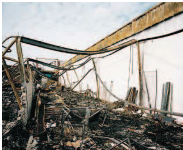
Les ancrages de fusion ont cédé du côté exposé au feu et la structure métallique a pu s'effondrer sans emporter le mur coupe-feu.
