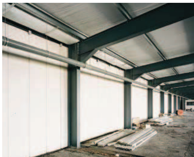
De l'autre côté du mur coupe-feu les ancrages de fusion sont intacts et le mur coupe-feu a rempli ses fonctions.
